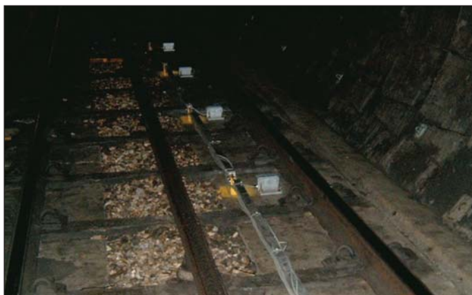
Obr. 3 Elektrické vodováhy (vlevo) a sklonoměry (vpravo) instalované na trati Fig. 3 Electrolevel beams (left) and tiltmeters (right) installed on track
