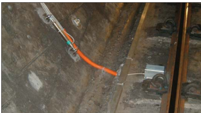
Obr. 4 Fotografie ukazuje (zprava doleva) sklonometr, elektrickou vodováhu, potenciometrický dilatometr a kabeláž vedenou na ostění tunelu Fig. 4 Photo shows (from right to left) tiltmeter, electrolevel beam, potentiometric crack meter, and cabling routed up tunnel lining.
